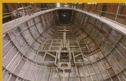
Le bateau retourné, on procède au renfort sur chaque point d'effort. Passe-coque, tube de jaumière sont soudés.
