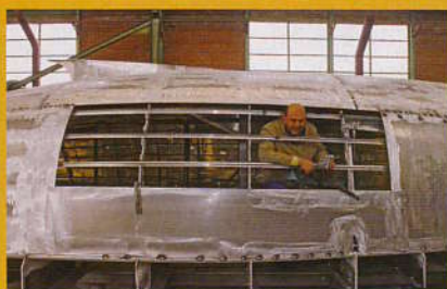
Les tôles d'un seul tenant, gage de solidité, sont pointées puis soudées (procédé étanche) sur les lisses et les couples.
